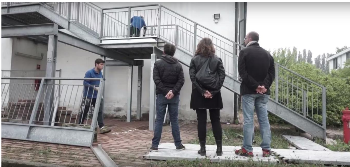
Operai al lavoro e Dirigenti della Stazione appaltante durante un sopralluogo effettuato da ActionAid il 27 aprile 2017
